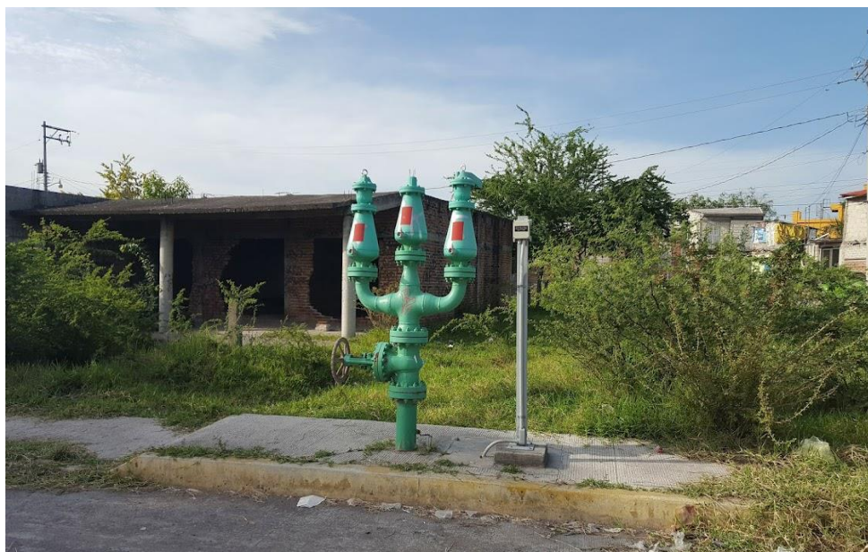
Ilustración 14. Válvulas que forman parte de las obras del gasoducto. Col. Gabriel Tepepa. 2019. Fotografía. Ana Laura Rivas
