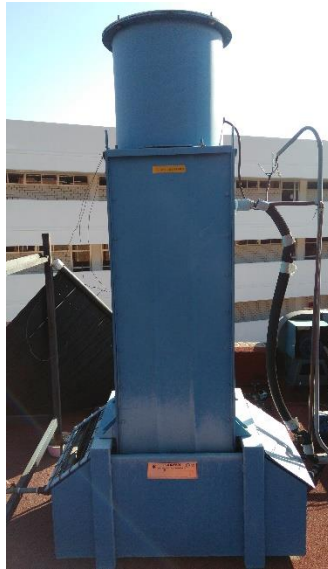
Figura 3.17.- Torre de enfriamiento
