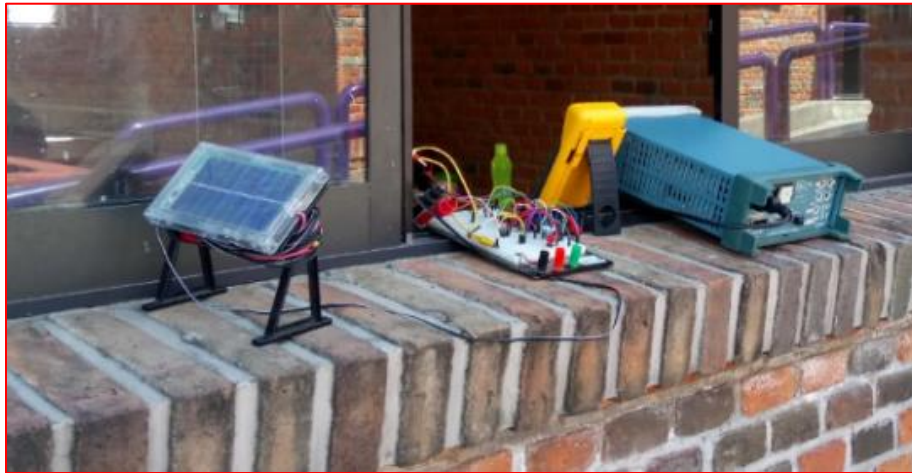
Figura 65. Conexión al panel.
