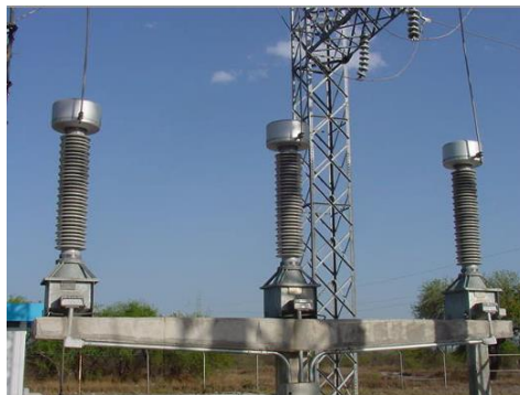
Figura 2.4 Transformadores de potencial [24].
