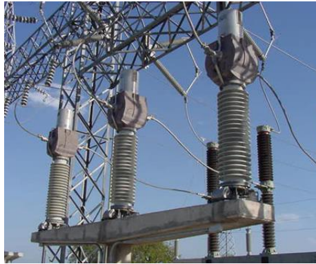
Figura 2.3 Transformadores de corriente [24].
