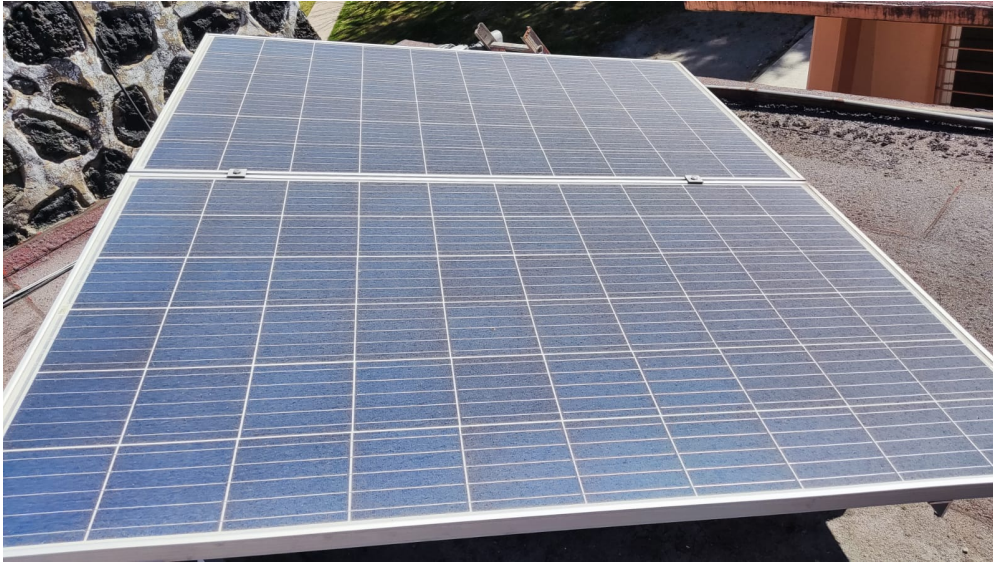
Figura 3.5 (b) Celdas fotovoltaicas del panel solar
