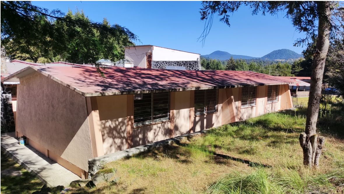
Figura 3.3 Aulas para climatizar
