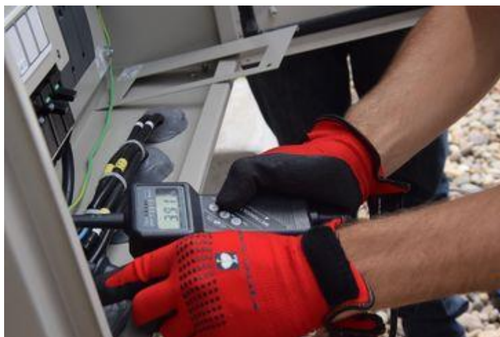
Inspecciones y mediciones de la planta solar fotovoltaica 8
