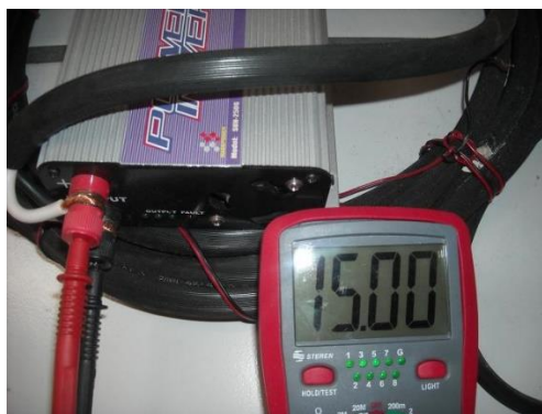
Inversor de corriente 6
