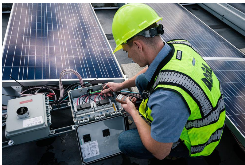
Gestión de calidad solar fotovoltaica 7
