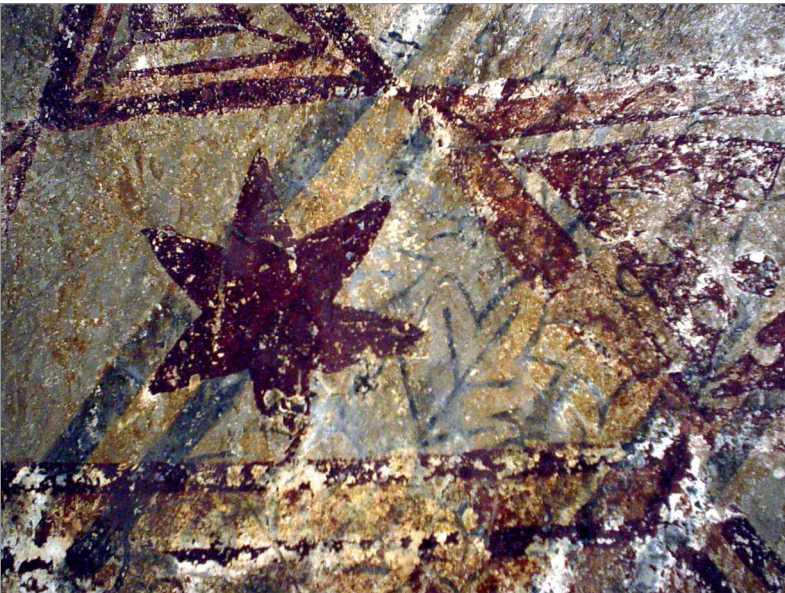
Figura 53: Sobreposición de aplanados, convento de Tlaquiltenango.
