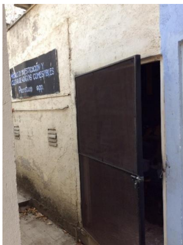
Figura 2. Parte externa del módulo CIB.
