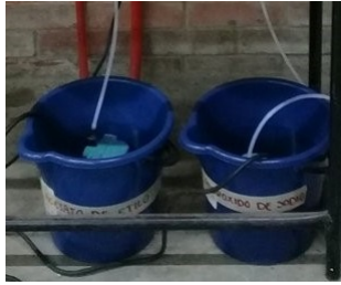
Figura C.3: Zona de bombas
