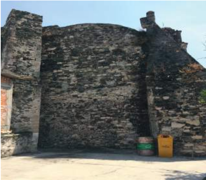
Figura 8. Muro 2 de la capilla. Se relaciona en el plano en color verde.
