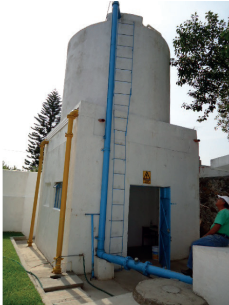
FIGURA 2. INFRAESTRUCTURA DEL POZO. CUERNAVACA, AGOSTO DE 2015. FOTOGRAFÍA: MANUEL ADAME CHAPA
