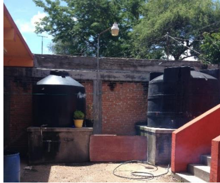
Imagen 5. Contenedores de agua en la entrada
