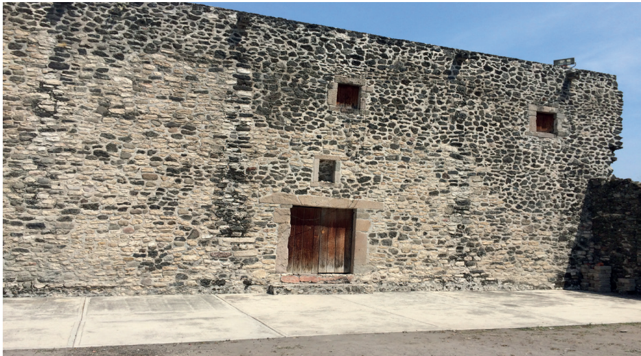
Figura 10. Muros 3 y 4 del claustro. Se relacionan en el plano en color azul.
