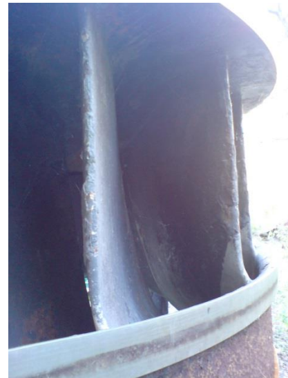
Figuras 4.20. y 4.21. Condiciones de rodetes con más de 40 años en servicio, con daños severos por cavitación y erosión.
