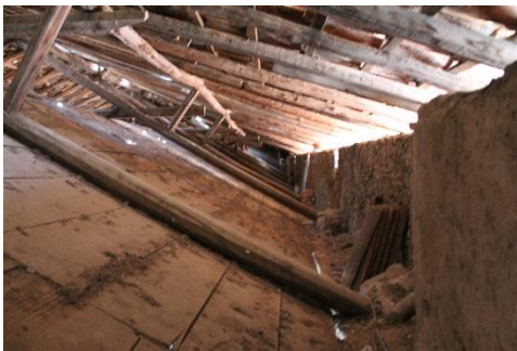
Figura: 8.- Cubierta con filtraciones de la capilla de San Nicolás Tolentino del Taxco el "Nuevo" Fotografía tomada por J. Omar Bahena Gutiérrez, 2017.
