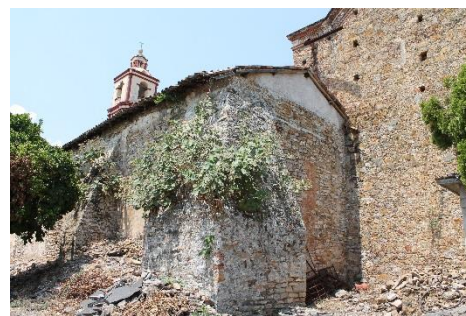
Figura: 11.- Muros de mampostería erosionados y plantas parasitas de la capilla de Santa María de la Luz en Tecapulco. Fotografía tomada por J. Omar Bahena Gutiérrez, 2017.
