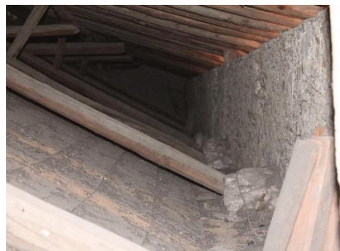
Figura: 32.- De talle del empotramiento de los tirantes de madera Foto, J.O.B.G. 2017
