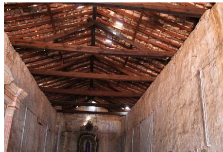
Figura: 9.- Cubierta con filtraciones de la capilla de Santa María de la Luz en Tecapulco. Fotografía tomada por J. Omar Bahena Gutiérrez, 2017.
