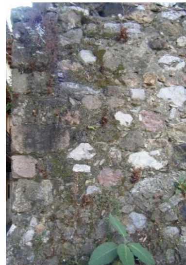
Figura: 99.- Muros de mampostería, y diversos tipos de piedras que se encuentran en la Capilla de San Nicolás Tolentino. Autor JOBG, Año. 2017
