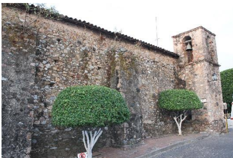
Figura: 10.- muros de mampostería con problemas de erosión y plantas parasitas de la capilla de San Nicolás Tolentino. Fotografía tomada por J. Omar Bahena Gutiérrez, 2017.
