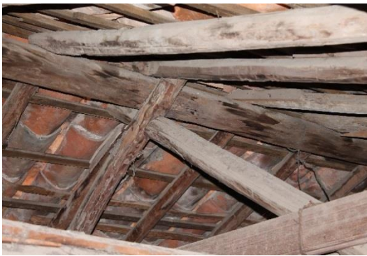
Figura: 31.-Interior de la cubierta de madera, de talle de las vigas. Foto, J.O.B.G. 2017
