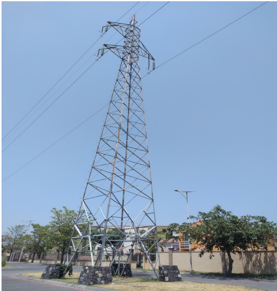
Figura 13. Torre de alta tensión dentro de La Provincia
