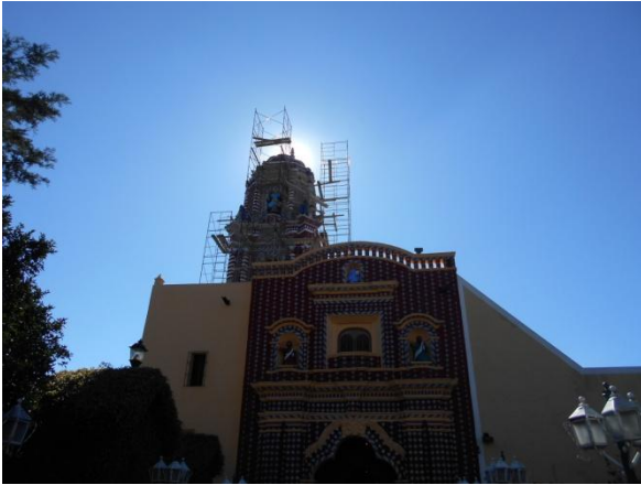
Foto 42. Torre dañada de la iglesia de Santa María Tonantzintla 101
