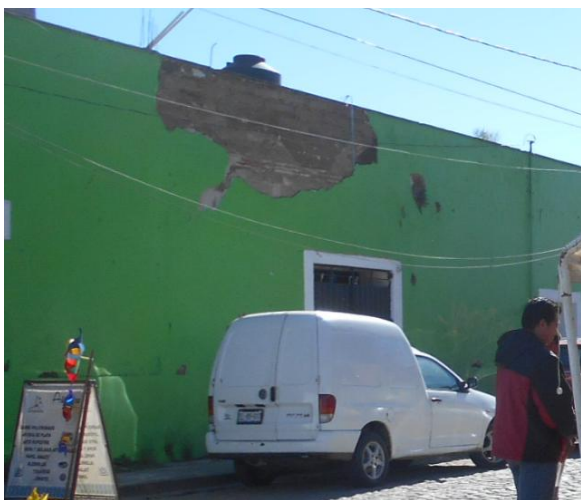
Foto 47. Construcción dañada por el temblor 106
