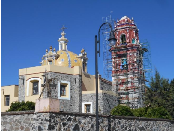
Foto 44. Torre dañada de la iglesia de Santa María Tonantzintla 103
