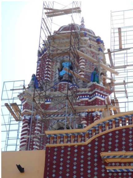
Foto 43. Torre dañada de la iglesia de Santa María Tonantzintla 102
