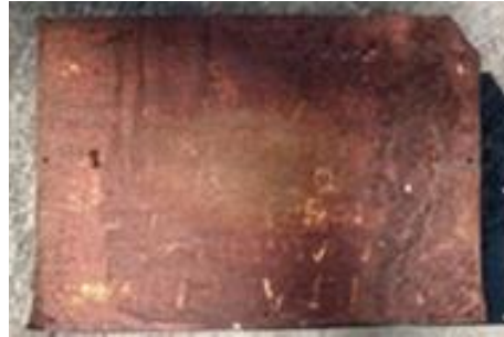
Figura 6. Fotografía de corrosión uniforme de metal expuesto en la azotea de una casa.
