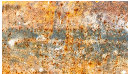
Figura 13. Corrosión por exfoliación 21 .
