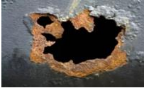
Figura 11. Tubería metálica que presenta corrosión-picadura.
