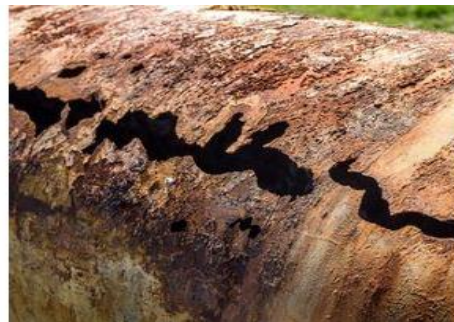
Figura 9. Tubería con ondulaciones y huecos.
