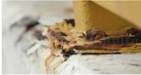
Figura 1. Corrosión Puente Tampico 6 .
