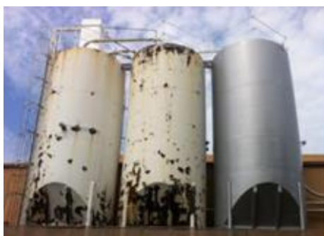
Figura 3. Corrosión en Tanques 10
