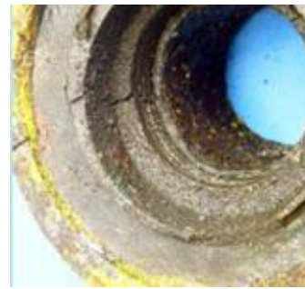
Figura 15. Ataque de corrosión selectiva.
