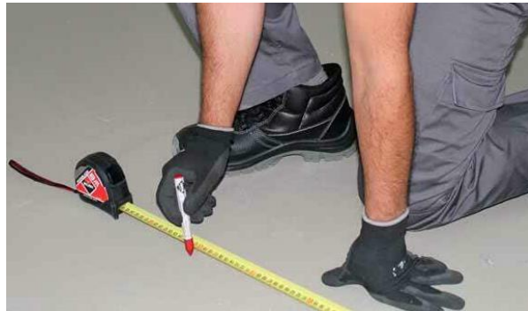
Figura 28: Toma de Medidas Correspondientes para la construcción del Sistema de Monitoreo Fuente: Elaboración Propia 2024
