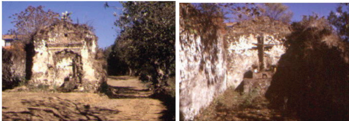
Imagen 11. Planta arquitectónica y fachada deteriorada de la Ermita. Fotografías tomadas del Catálogo Nacional de Monumentos Históricos Inmuebles del INAH.
