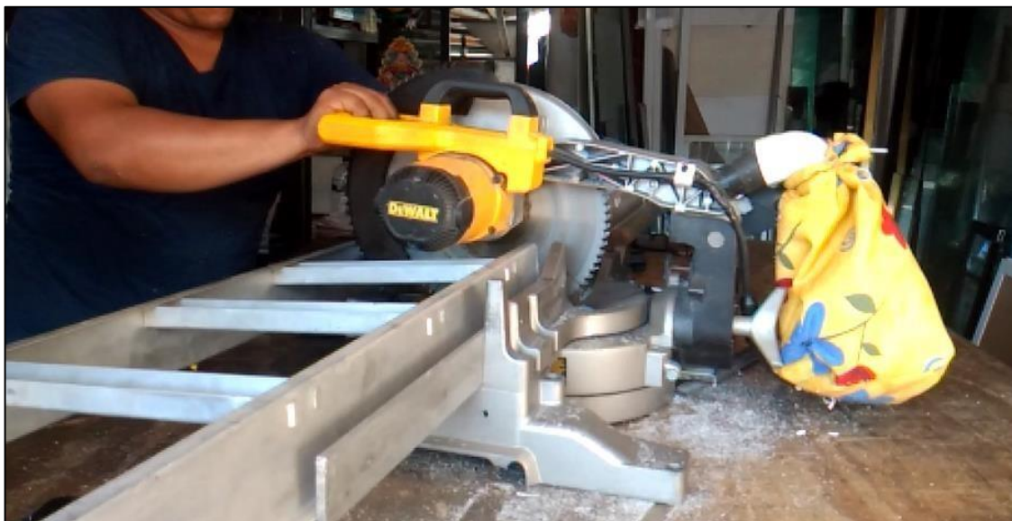
Imagen 21. Zúñiga Fernando. (2020) corte del soporte para cableado [imagen]
