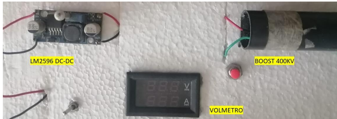
Figura 3.10 Conexión del BOOST 400 kV.
