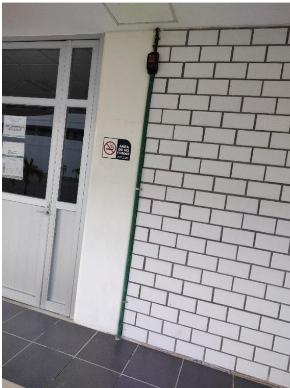
Bajada de cable para su conexión a la malla de puesta a tierra
