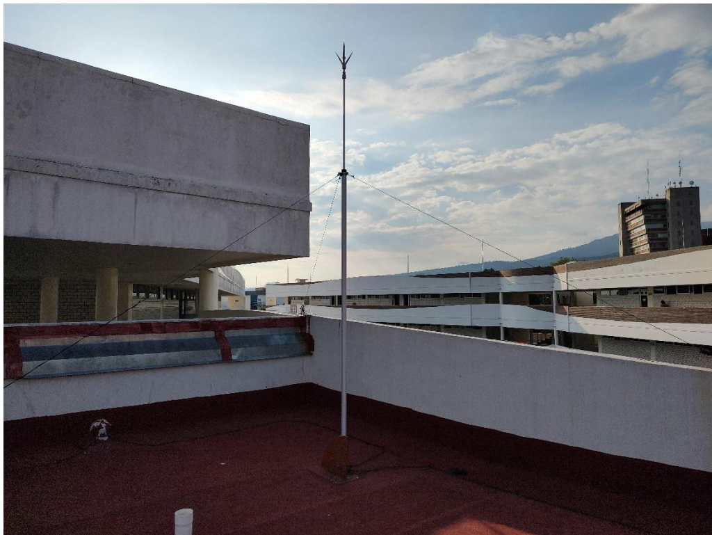
Pararrayos mostrando punta captadora, mástil de dos secciones, cables sujetadores de acero y base de pararrayos
