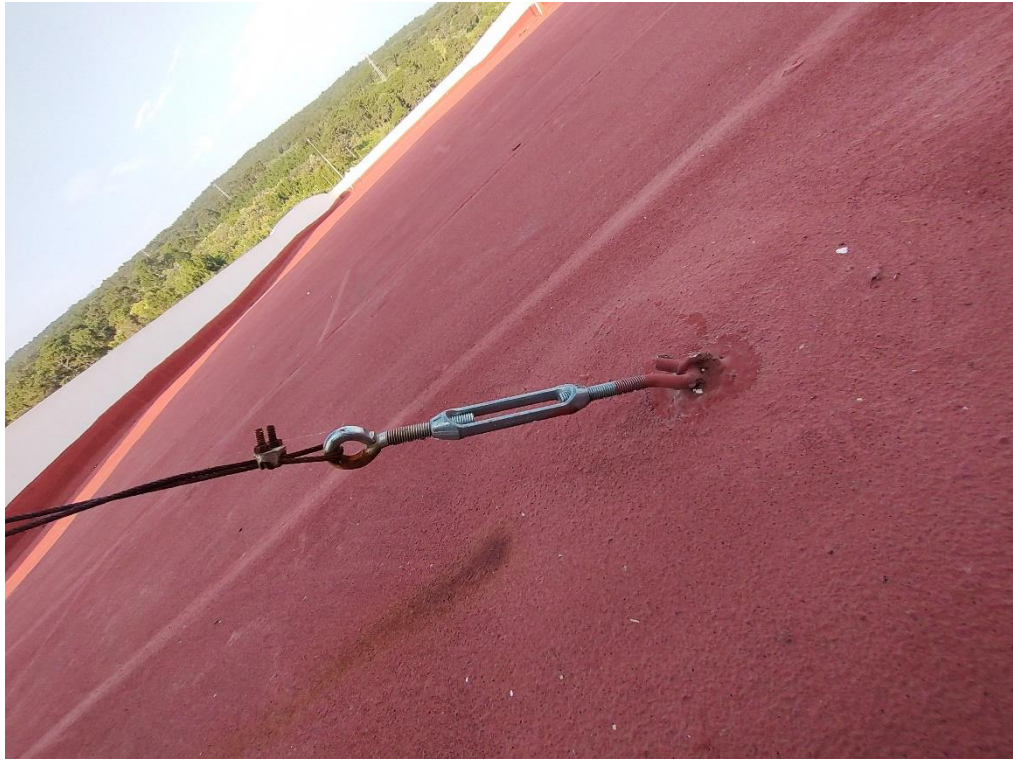
Tensores con armellas y sujeta cables de acero
