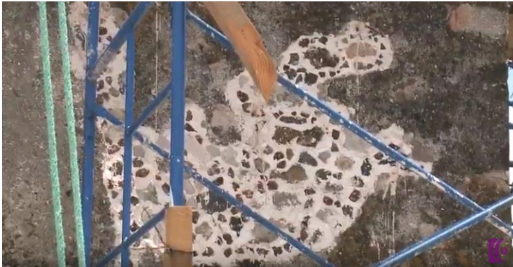
Figura 87. Rajueleo aplicado para rellenar zonas con fisuras considerables en la torre campanario (Monzalvo, 2019).
