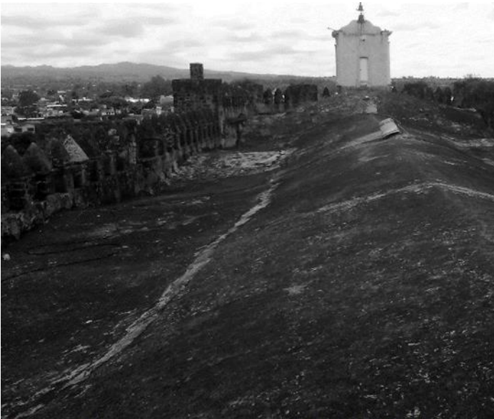
Figura 64. Confirmación del agrietamiento en el extradós de la bóveda del templo de acuerdo a lo obtenido con el cálculo de la línea de presiones (en la fotografía se aprecia el resane de una grieta que en algún momento existió. Foto tomada por el autor Febrero 2017).
