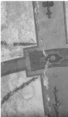
Figura 34. Agrietamiento en bóveda de la iglesia después del sismo del 19 de Septiembre de 2017. Fotografía tomada de un video de Francisco Erick Sánchez Zavala
