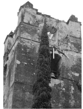
Figuras 35, 36 y 37. Daños encontrados en el exterior después del temblor del 19 de septiembre de 2017, en la primera imagen se observa el colapso del garitón de un contrafuerte, en la segunda imagen se muestra la pérdida del rosetón y en la tercera se aprecia el colapso de la parte superior de la torre. Fotografías de Francisco Erick Sánchez Zavala
