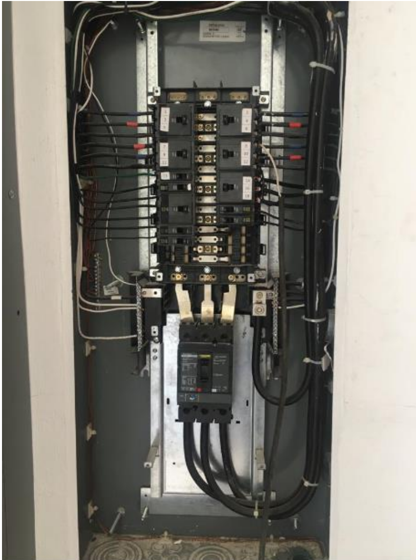
FIGURA 27.-GABINETE DE ALIMENTACION DEL COMPLEJO FCQeI EDIFICIO 36B.
