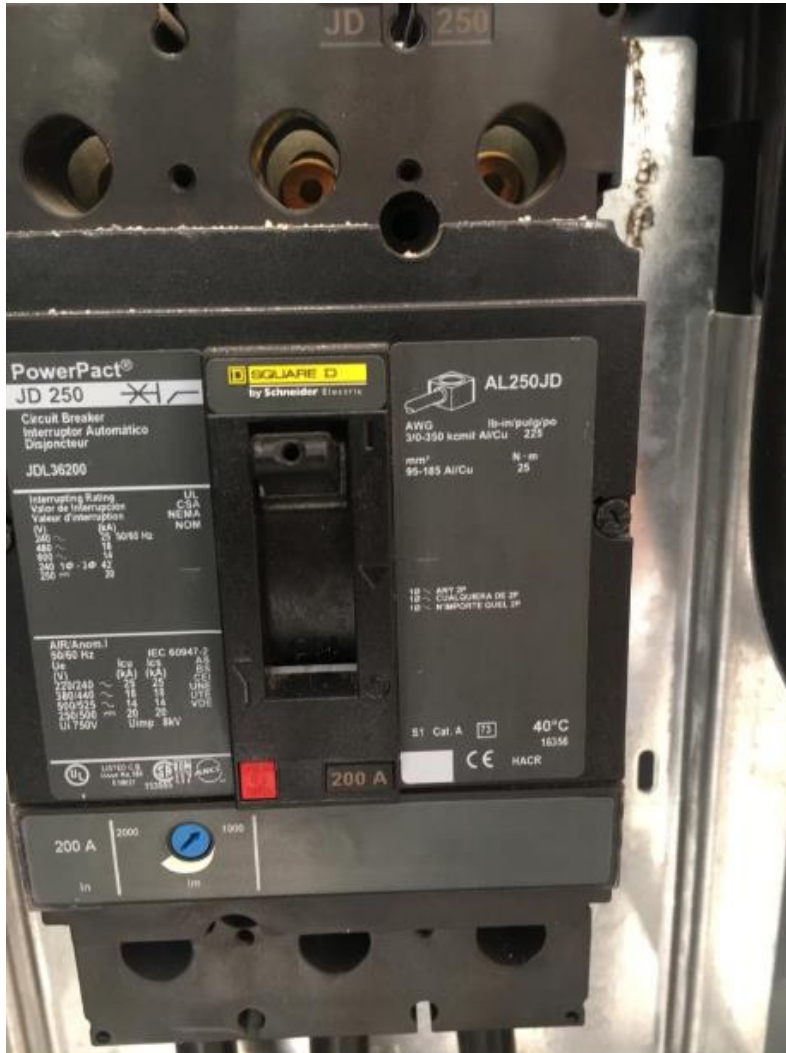
FIGURA 27.1.- INTERRUPTOR PRINCIPAL DEL ELEVADOR.
