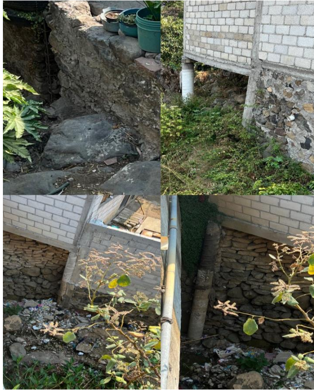
Imagen 22 – Cimentación de las viviendas de la barranca Cuatizec, en el municipio de Tlalnepantla Morelos.
