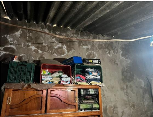
Imagen 15–humedad de la vivienda en la barranca Cuatizec.
