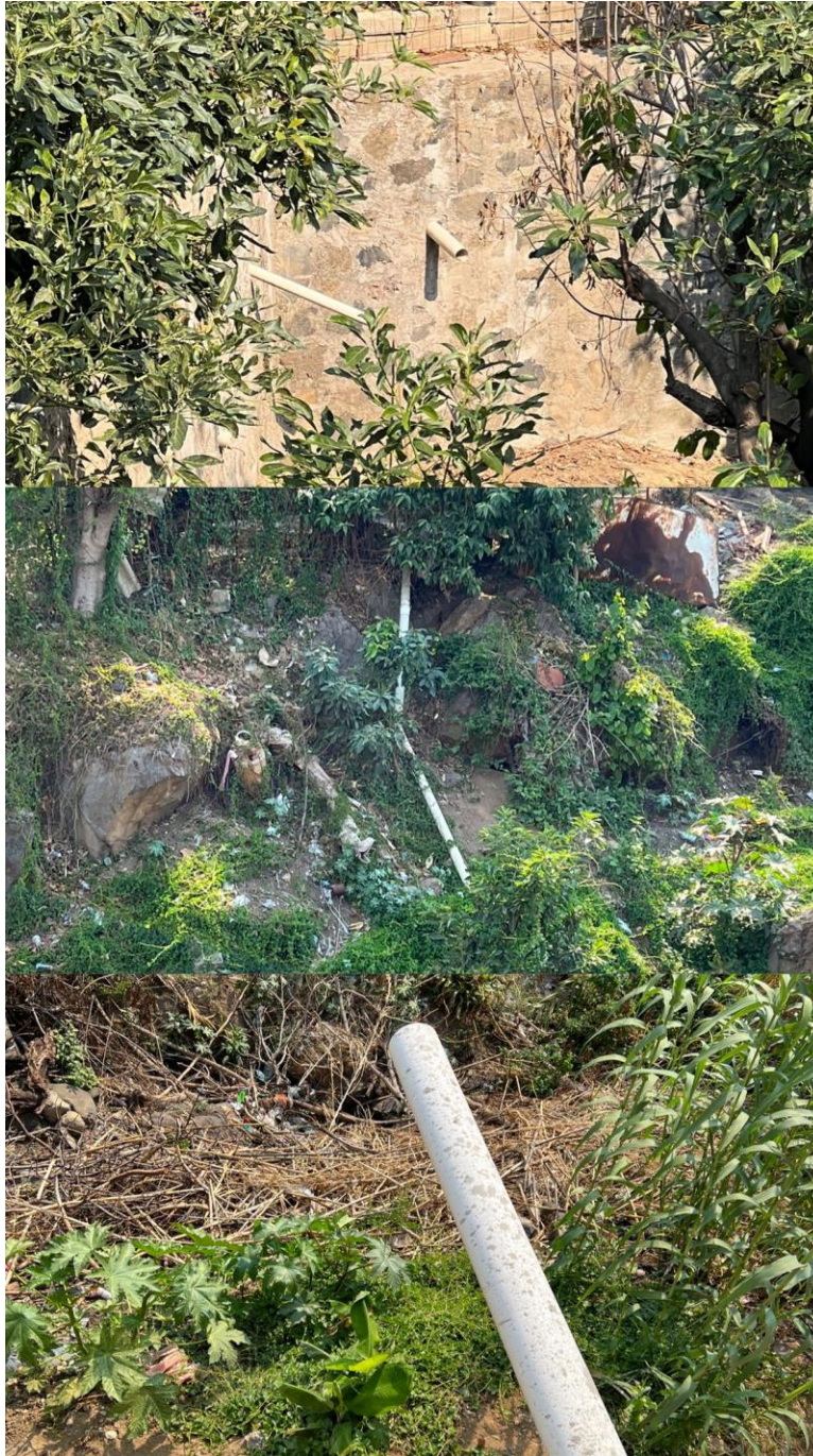
Imagen 32 – Arrojamiento de drenaje de viviendas de la barranca Cuatizec, en el municipio de Tlalnepantla Morelos.
