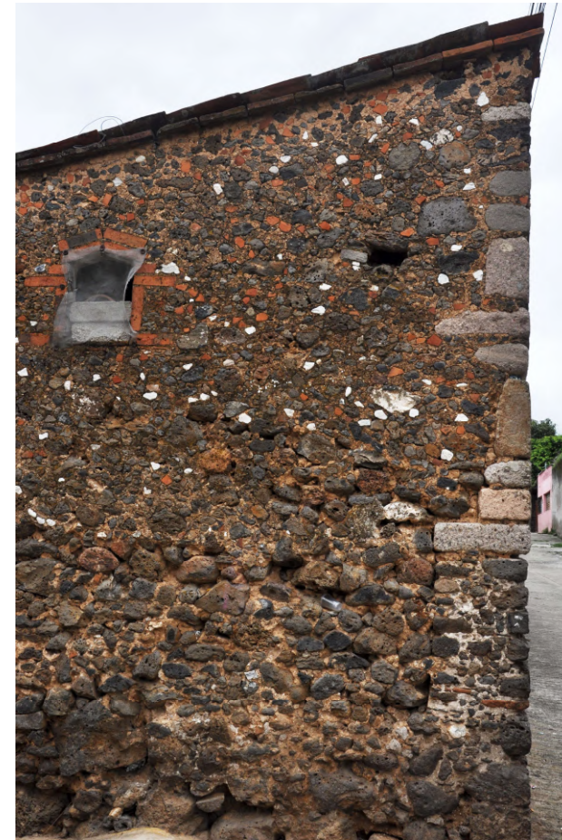
Detalle de las canteras como elemento estructural que soportan los muros y techos.
