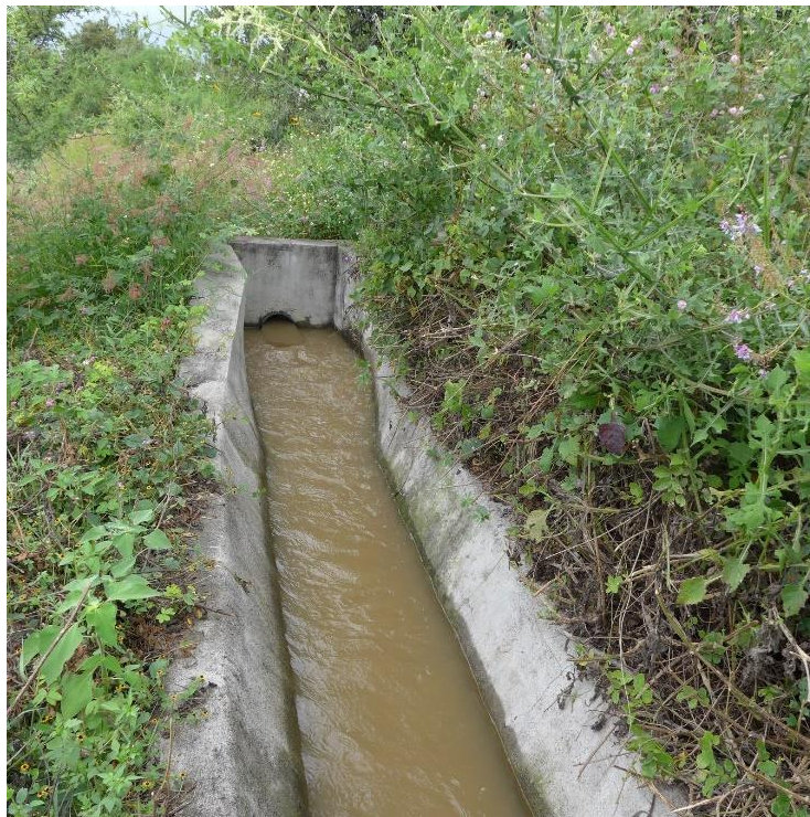
Foto 19. Canal de salida del cárcamo, Popotlán. Temoac, Morelos. 11 de octubre de 2018. Foto de ENG.
