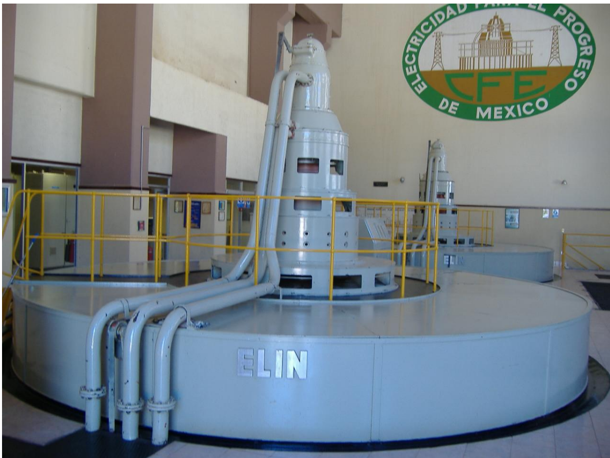
Figura 17: Vista del Piso de Generadores de la C. H. Oviachic
