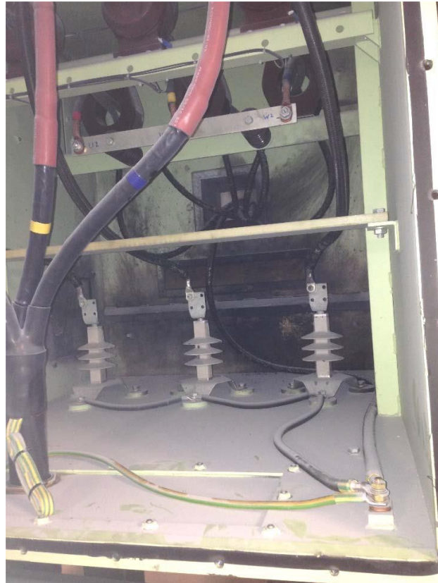
Fig. 2.15 Daños en la celda de alimentación del motor D701 causados por sobretensiones y fallas a tierra.
