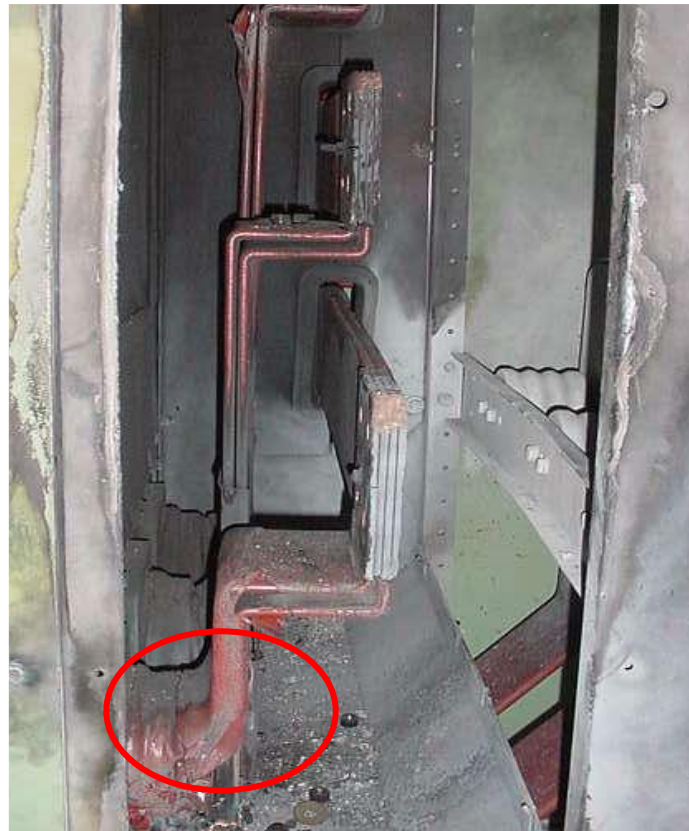
Fig. 2.11. Evidencia de falla a tierra intermitente, por tracking
