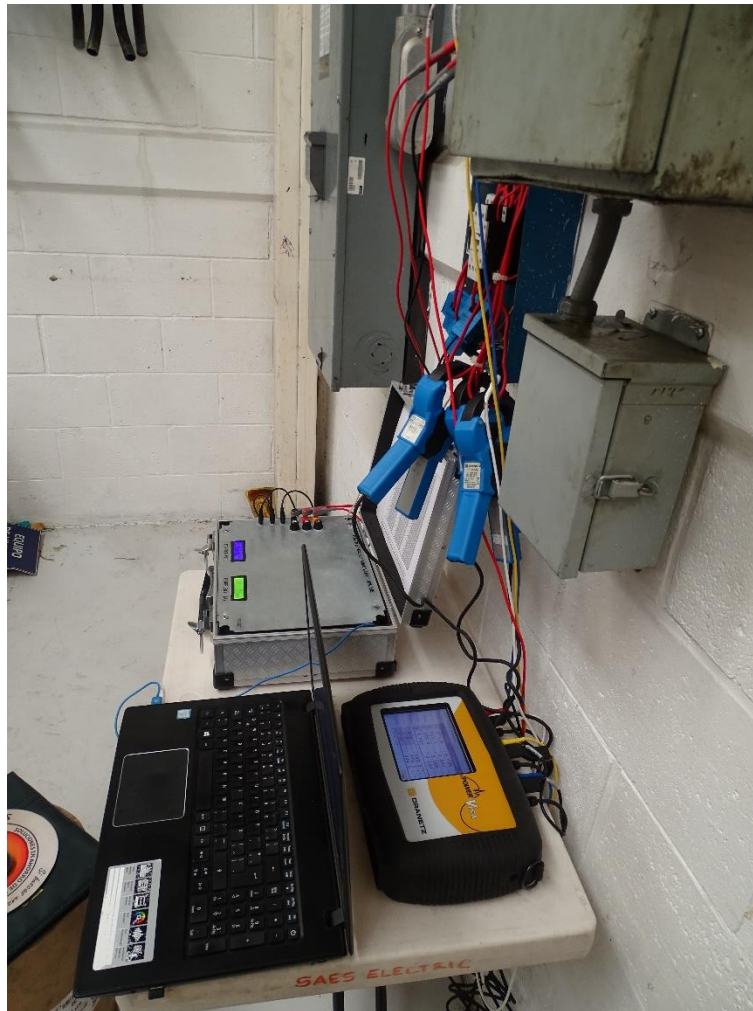
Figura 4.1. Conexión de sensores en tableros eléctricos energizados.
