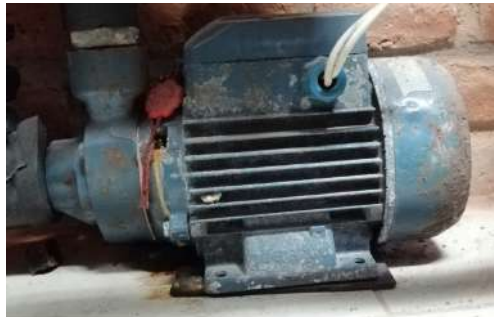
Figura 3.19: Bomba para el circuito de enfriamiento
