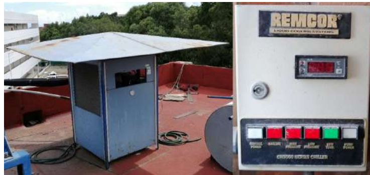
Figura 3.8: Chiller y tablero de control
