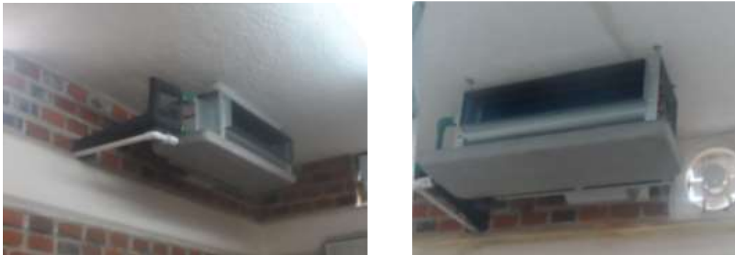
Figura 3.21 Unidades evaporadoras instaladas.
