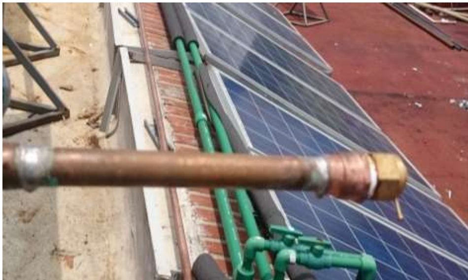
Figura 3.23 Válvula de alivio, ubicada al final de la línea.
