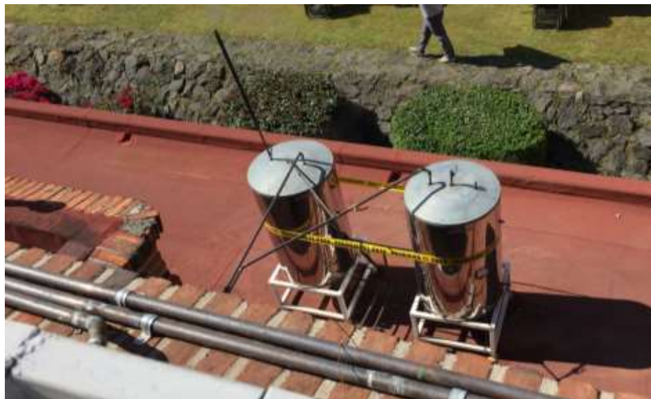
Figura 3.30 Termotanques en operación.
