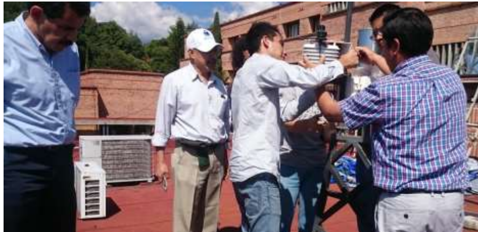
Figura 3.19 Instalación estación meteorológica.
