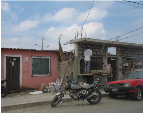
La única ampliación posible en planta baja, en socio vivienda 1, es hacia la galería. La estructura original no soporta una segunda planta.
