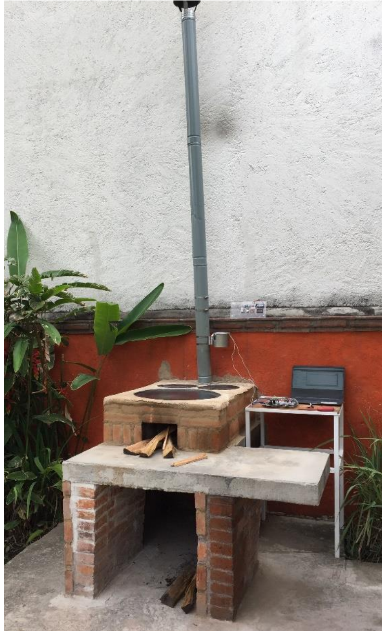
Figura 3.25 Instalación del dispositivo de generación termoeléctrico
