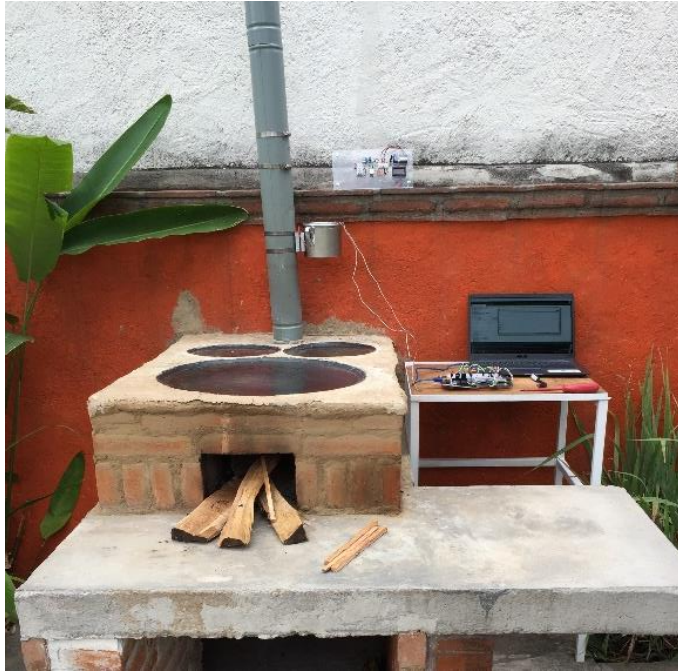
Figura 3.26 Conexión entre el dispositivo de generación termoeléctrico y el dispositivo de acondicionamiento del voltaje
