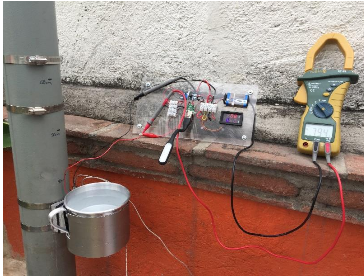
Figura 3.13 Montaje del dispositivo para el acondicionamiento de la señal de entrada (voltaje)
