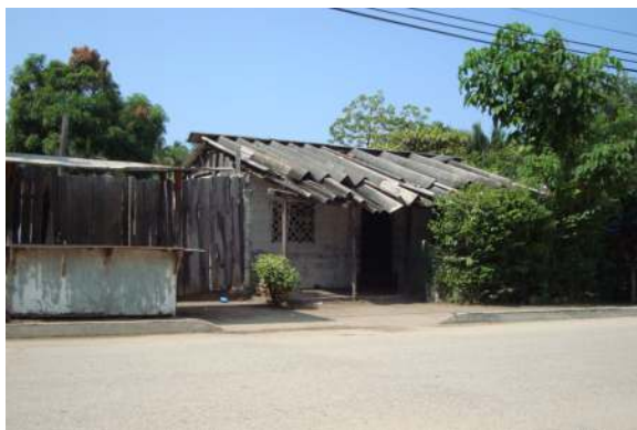
Foto 3.33 Tipología de vivienda vernácula modificada y deteriorada.
