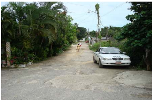
Foto 3.31 Vialidad con asfalto en mal estado.
