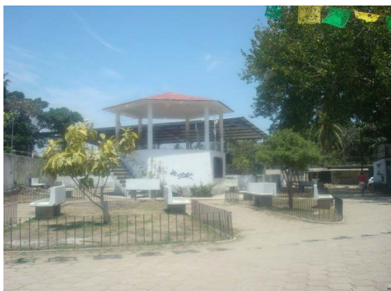
Foto 3.3 Vista de equipamiento, donde se muestra el deterioro de la construcción y descuido de áreas verdes.
