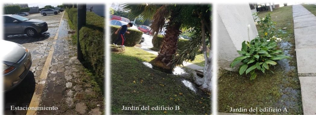
Fuga de agua subterráneas, presentes en áreas comunes
