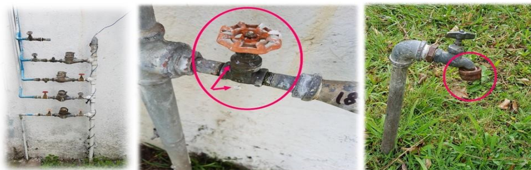
Fuga de agua superficiales en tomas domiciliarias de departamentos y grifos de jardín.
