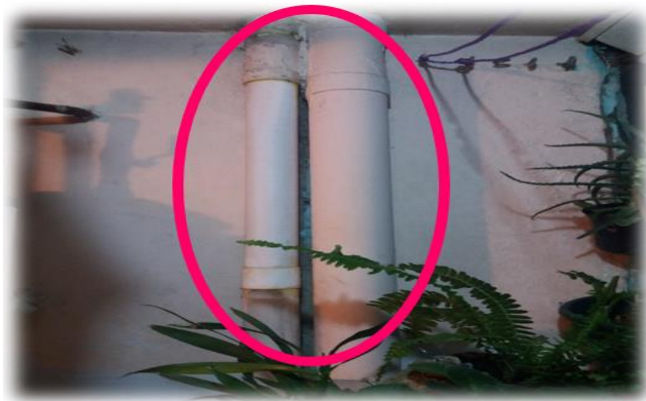
Figura 46. Doble sistema sanitario de aguas residuales de los departamentos del CAV. Fuente: Arce, 2018.
