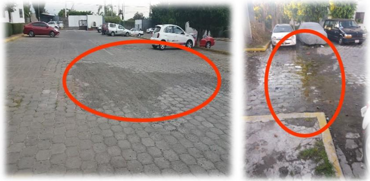
Figura 20. Hundimiento de piso en el estacionamiento del CAV por filtraciones de agua. Fuente: Arce, 2018.
