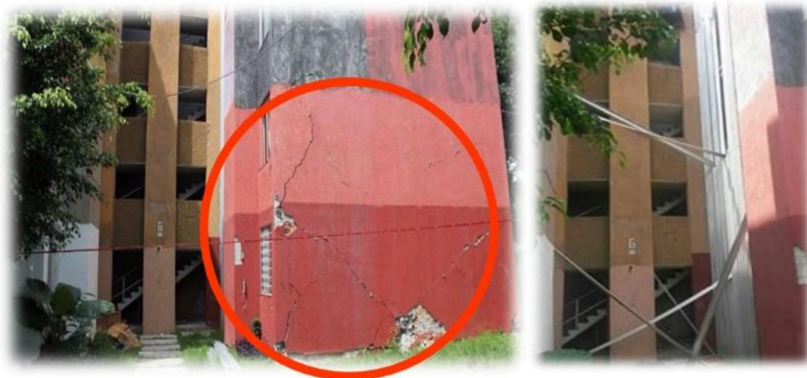
Figura 16. Edificio G del CAV, afectado por el sismo del 19/09/2017. Fuente: Facebook_Conjunto Altavista-Edificio G, 2017.
