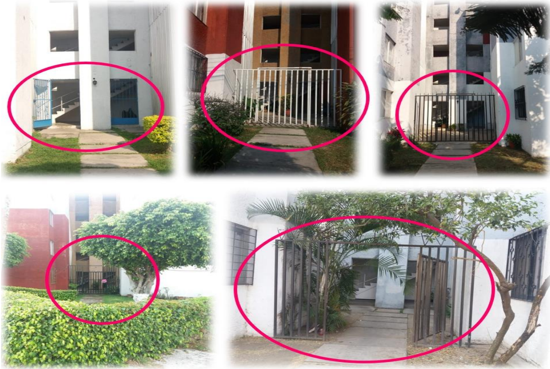
Figura 23. Rejas de seguridad instaladas en entradas de los edificios B, D, F, H, y P del CAV. Fuente: Arce, 2019.
