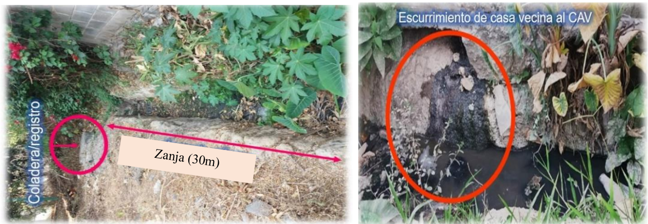
Figura 22. Escorrentía de agua jabonosa en una pared de casas vecinas hacia el CAV. Fuente: Arce, 2018.
