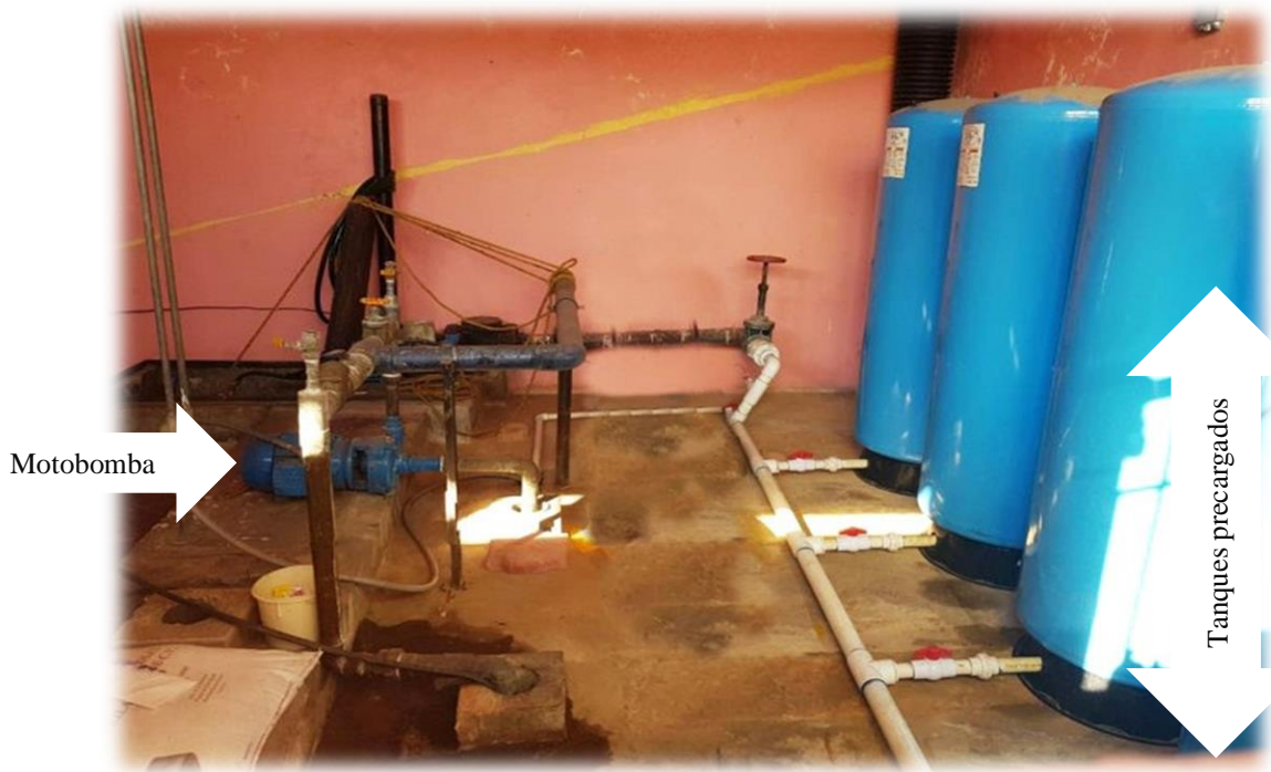
Figura 39. Sistema de bombeo instalado en el CAV. Fuente: Márquez, 2019.
