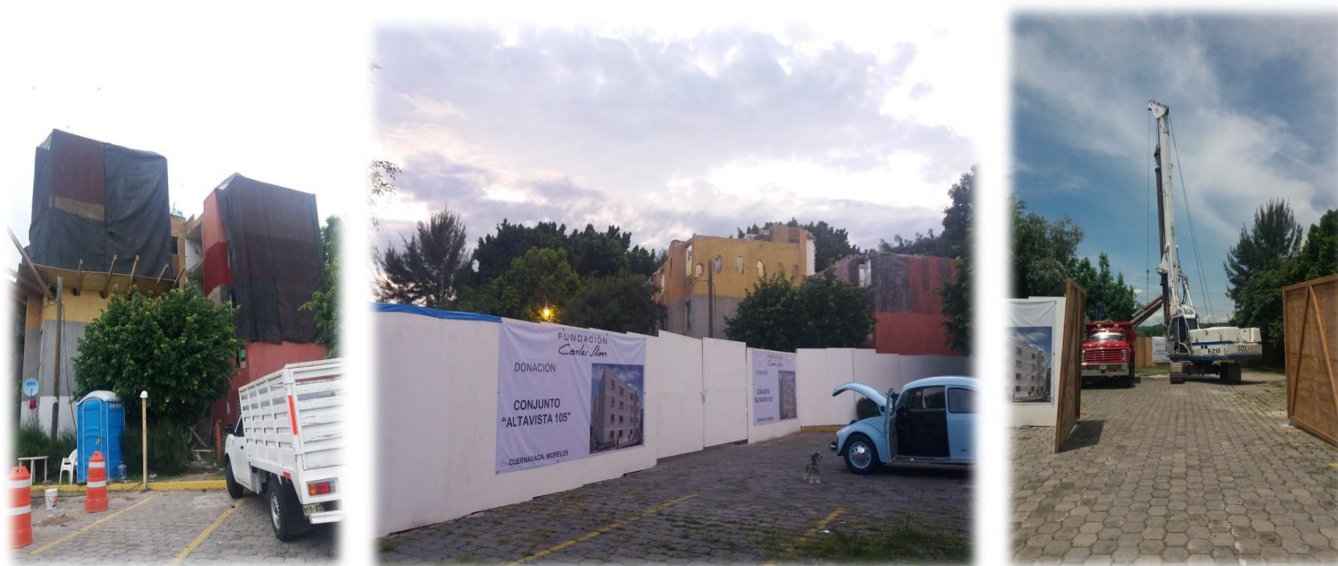
Figura 33. Inicio de los trabajos de demolición del edificio G del CAV. Fuente: Arce, 2019
