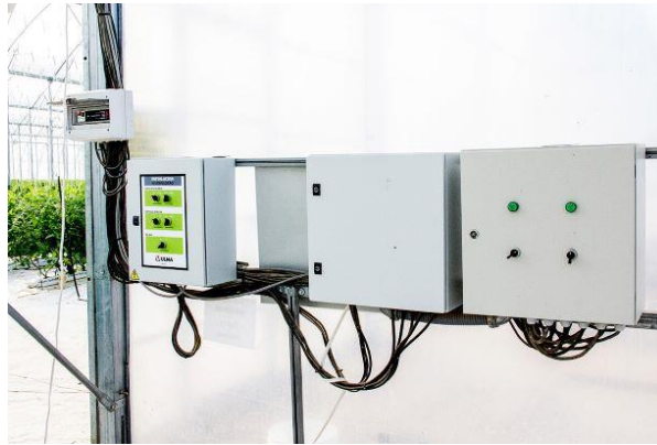
Figura 1.3 Tableros de Control para un sistema automatizado de invernaderos
