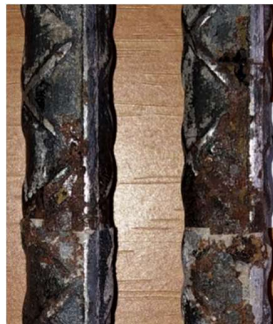
Figura 4. 48. Varillas de acero extraídas del concreto posterior a los 300 días de exposición al medio agresivo, para la muestra control.
