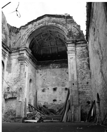
Figura 61. Bóveda de presbiterio en estado ruinoso, iglesia de Tapalapa. Fotografía: Figueroa Esquinca, 2013
