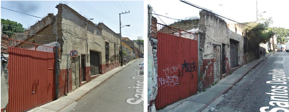
Figuras 24, 25, Efectos del abandono del inmueble y problemas ocasionados por la falta de mantenimiento (Fotografías recuperadas de Google Maps: 2009 - 2015).
