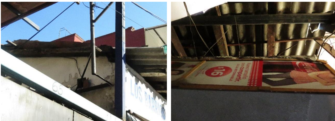
Figuras 26, 27, Cubierta de lámina de asbesto en inmuebles originales con uso distinto (Fotografías tomada por el autor, 2019).
