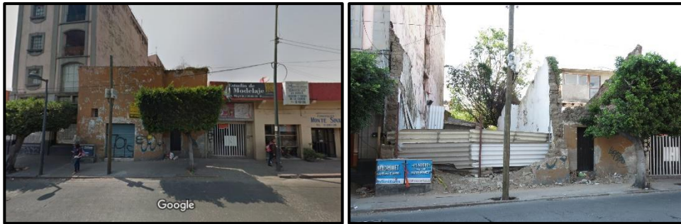
Figuras 3, 4. Daños ocasionados por falta de mantenimiento y tras el sismo del 19/septiembre/2017. (Figura 3, fotografía recuperada de Google Maps,2000), (Figura 4, fotografía tomada por el autor, 2017).
