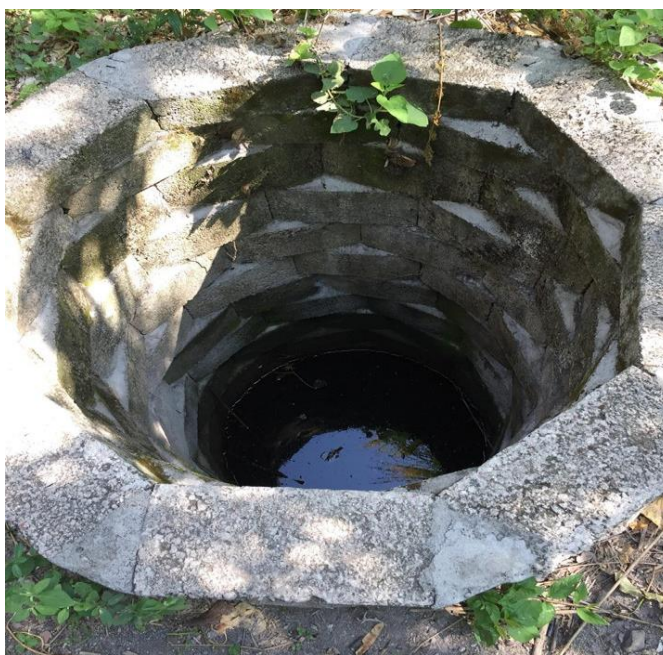
Imagen 3 , depósito de agua en la localidad de Jicaman, Cuautla, Morelos.
